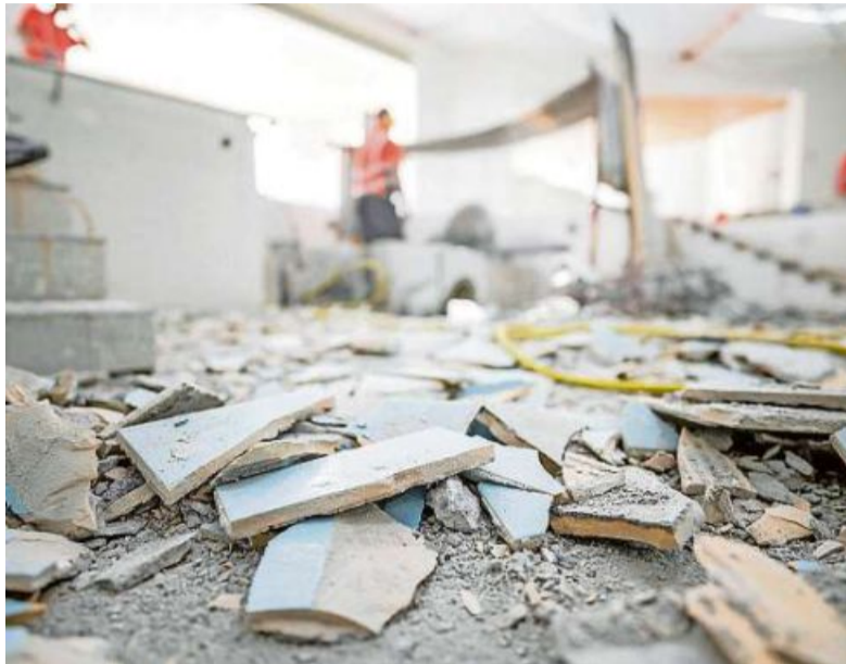
Fleissige Hände: Die Renovationsarbeiten im Bogn Engiadina in Scuol sind in vollem Gang. Bilder: Mayk Wendt
